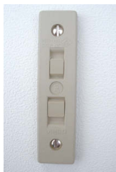
1053 (洗面所コンセント)
